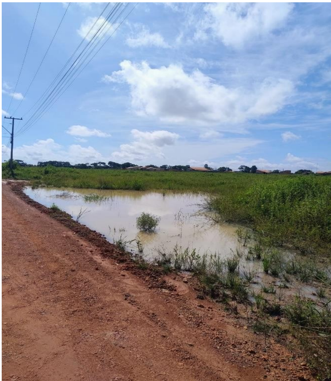
Foto 4 – Atoleiro oriundo da chuva, em rua do bairro
